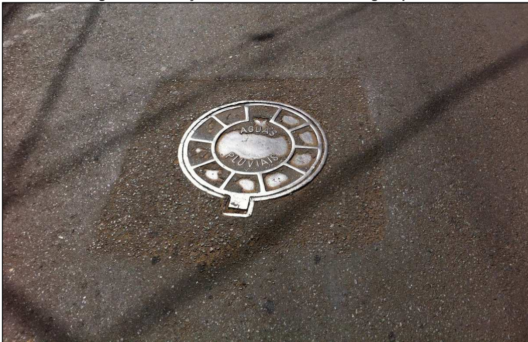
Figura 3.57 – Poço de visita da rede de drenagem pluvial.
