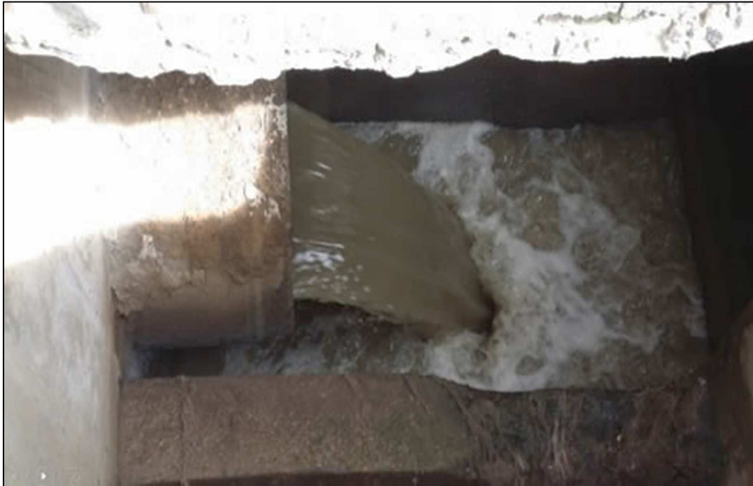
Figura 3.44 – Esgoto bruto na chegada da ETE.
