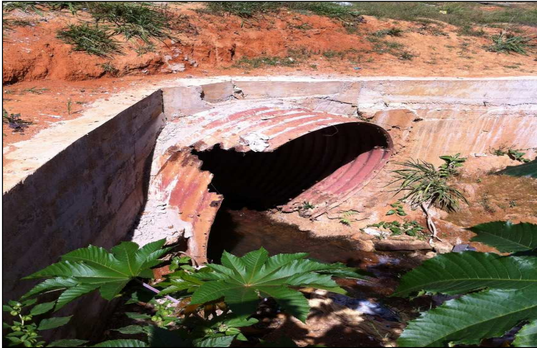
Figura 3.64 – Dispositivo de macrodrenagem danificado.
