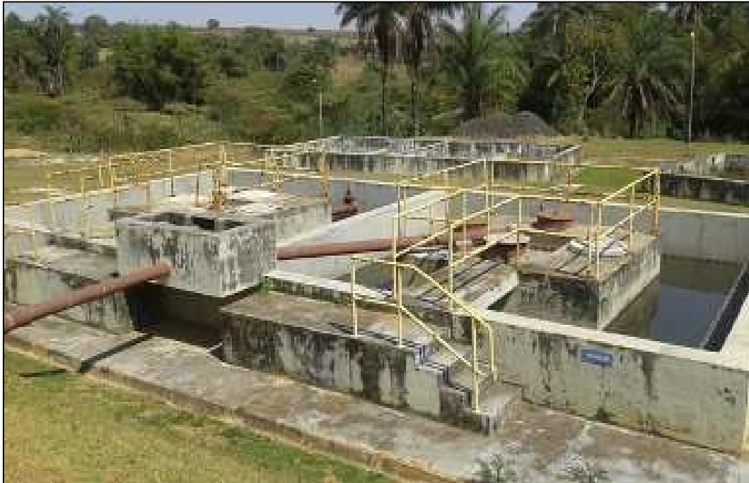
Figura 3.40 – Estação de tratamento do esgoto - ETE Boa Vista.
