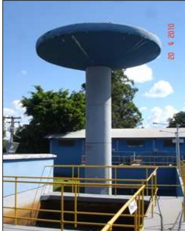
Figura 3.34 – Reservatório elevado para lavagem dos filtros.
