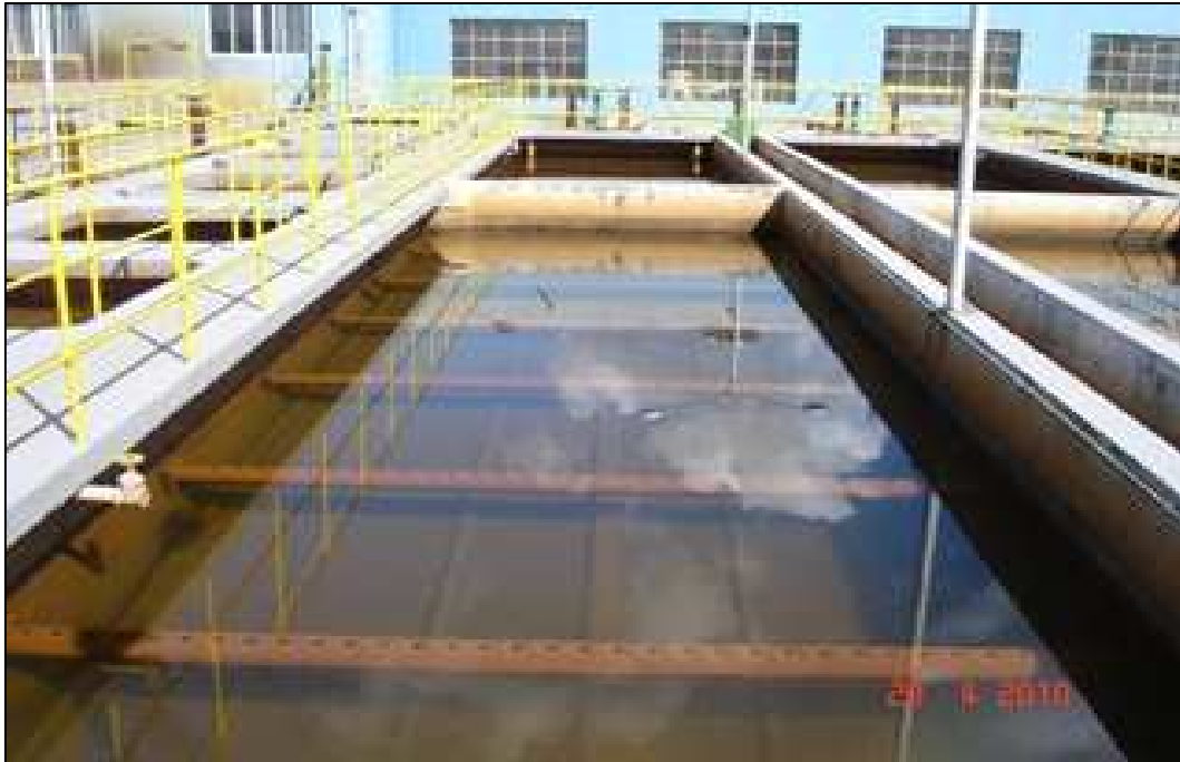
Figura 3.28 – Decantadores da ETA.
