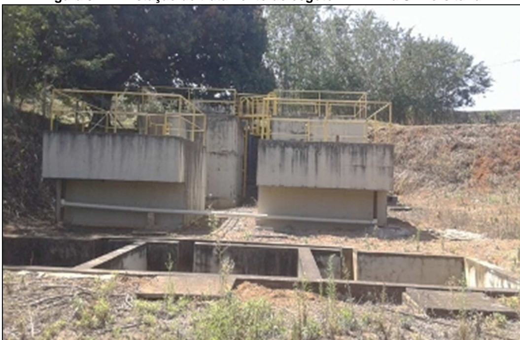
Figura 3.41 – Estação de tratamento do esgoto - ETE Vila Universitária.
