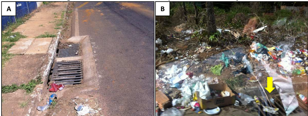
Figura 3.58 – Bocas de lobo com problemas de obstrução.
