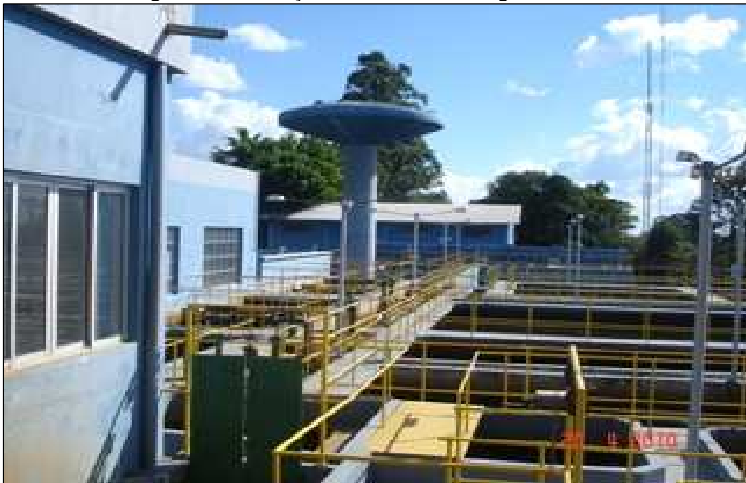
Figura 3.24 – Estação de tratamento de água de Araxá.
