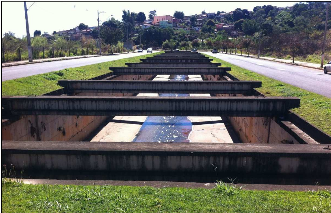
Figura 3.54 – Direcionamento de águas pluviais através de galerias - Av. Rosalvo Santos.
