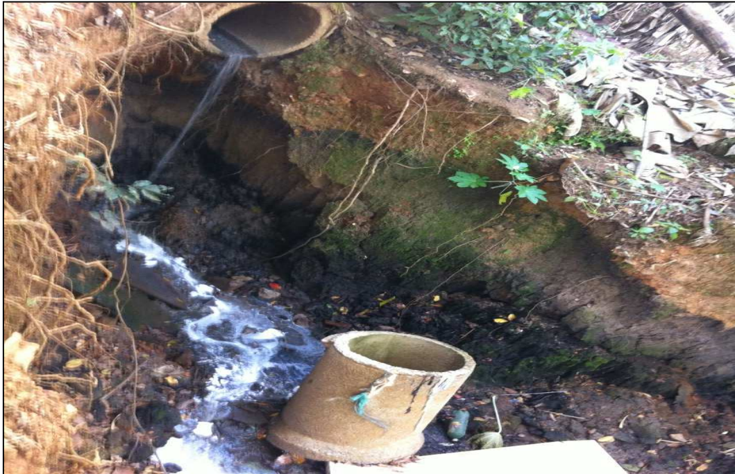
Figura 3.67 – Despejo irregular de esgoto em áreas de drenagem natural.
