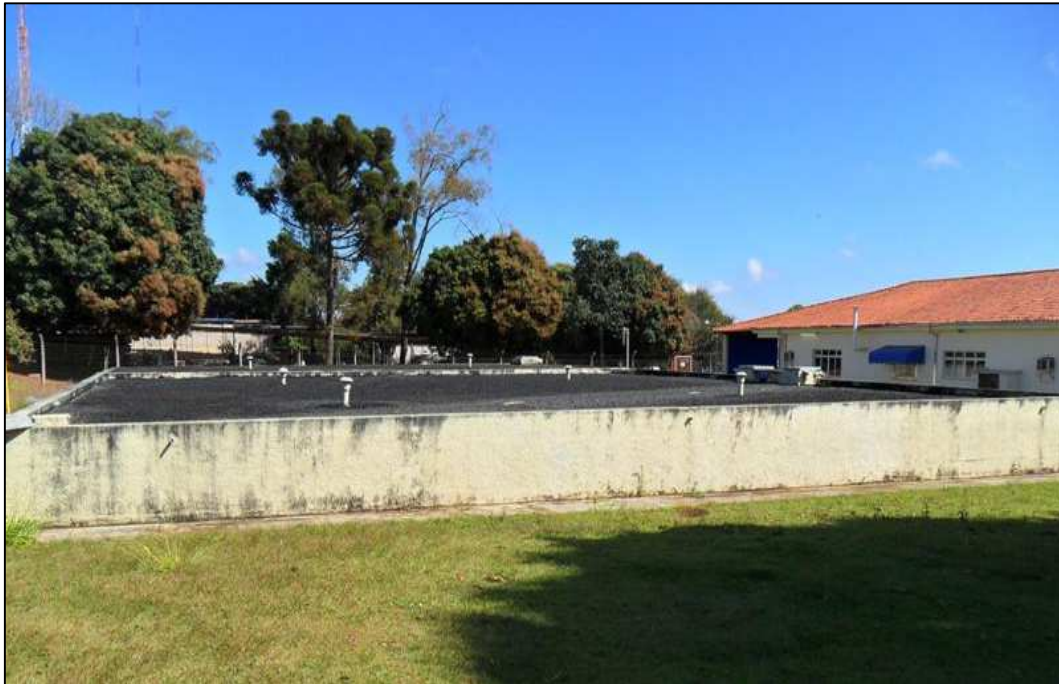
Figura 3.35 – Reservatório semienterrado RSE 01.
